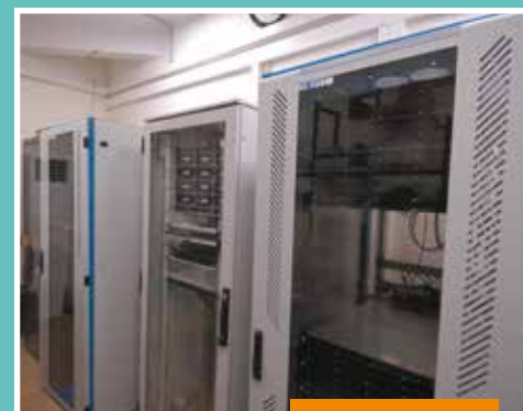
Salle des serveurs
